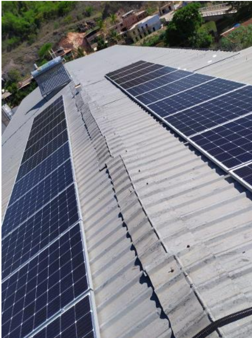
Figura 18 – Instalação Conjugada Termossolar e Fotovoltaica.
