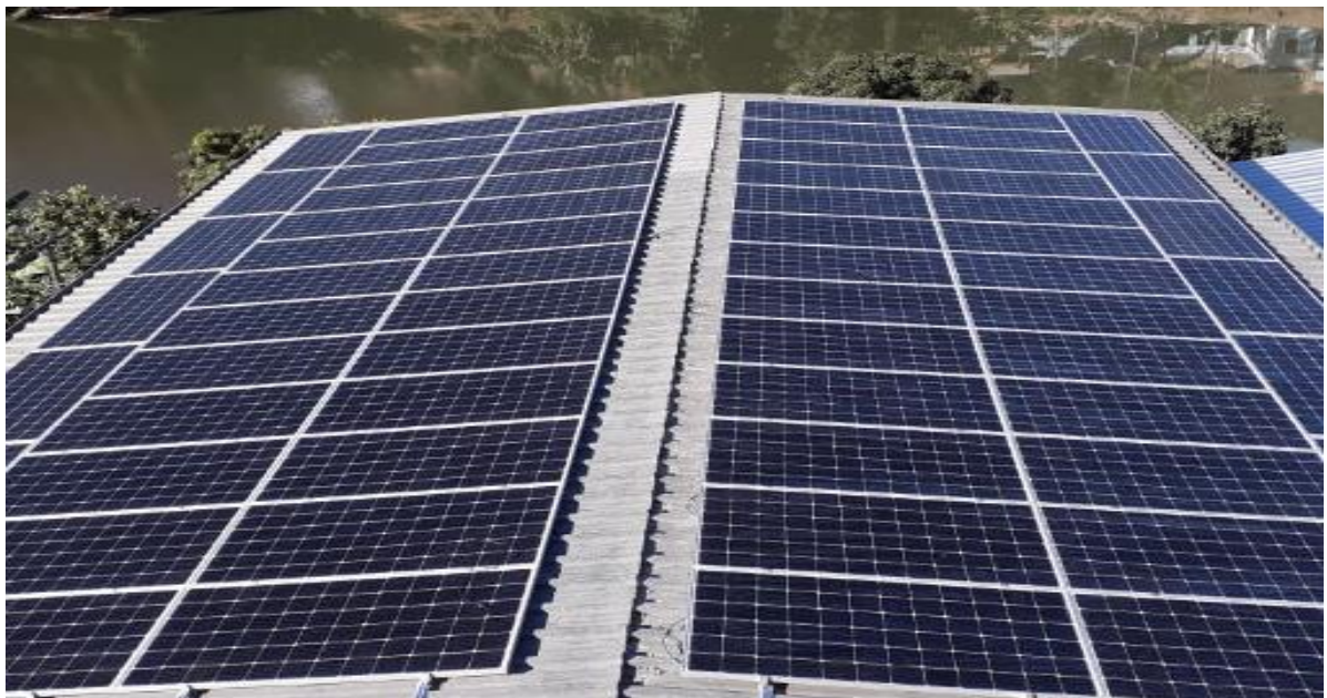
Figura 14 – Usina Fotovoltaica 60kWp.
